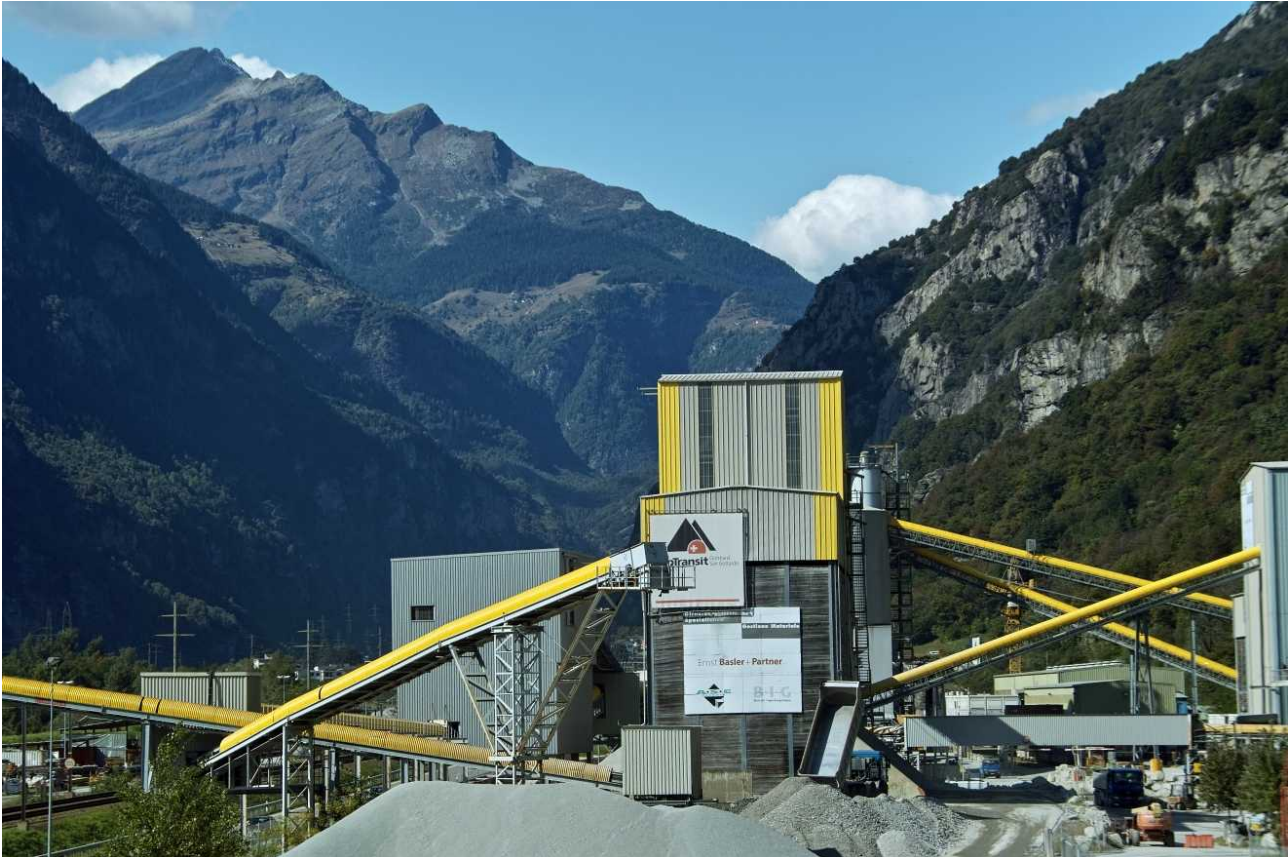
NEAT-Baustelle in Bodio mit einer großen Anlage zur Zubereitung der im Tunnel benötigten Betone; alle Fotos J. LORENZ.
